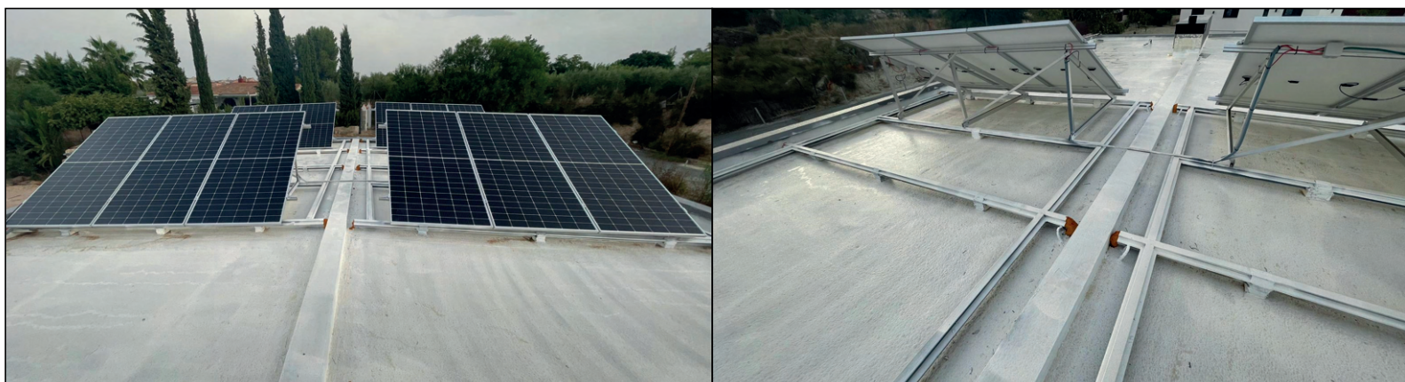
Detalle enganche placas solares a los ganchos de transporte
